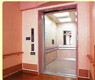
エレベーター
